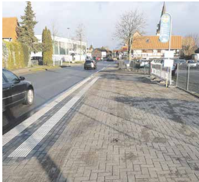
Die Tiefbau- und Pflasterarbeiten an der Haltestelle »Hauptstraße« im Ortsteil Esbeck sind bereits abgeschlossen Foto: Stadt Schöningen
