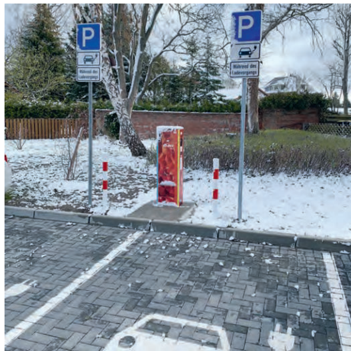
Die E-Ladesäule auf dem Bahnhofsvorplatz ist momentan die einzige in ganz Schöppenstedt Foto: Nickel
