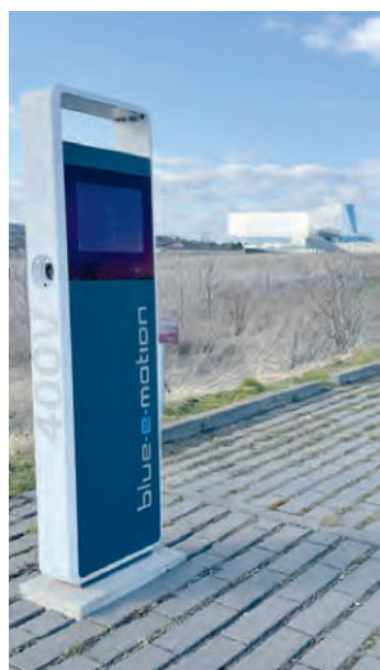
Schöningen weist aktuell nur zwei Elektro-Ladesäulen auf – eine gut frequentierte am Marktkauf und diese (defekte) am Forschungsmuseum
