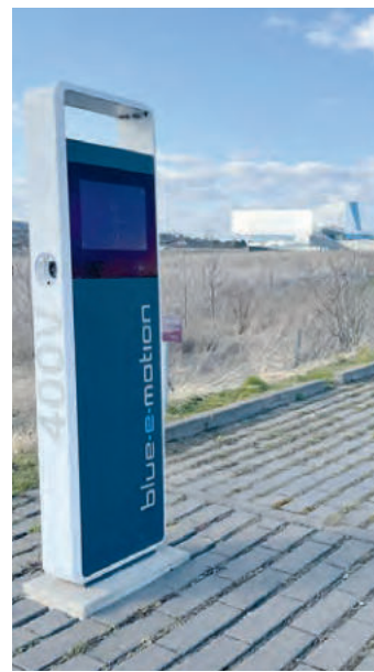
Schöningen weist aktuell nur zwei Elektro-Ladesäulen auf – eine gut frequentierte am Marktkauf und diese (defekte) am Forschungsmuseum
